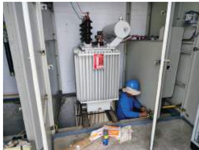
⬆ Mantenimiento preventivo de subestación eléctrica
