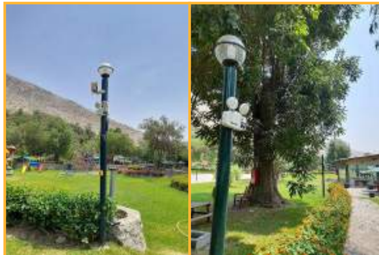
INSTALACIÓN DE LUCES DE EMERGENCIA EN EL CAMPO Y SIRENA DE EMERGENCIA
