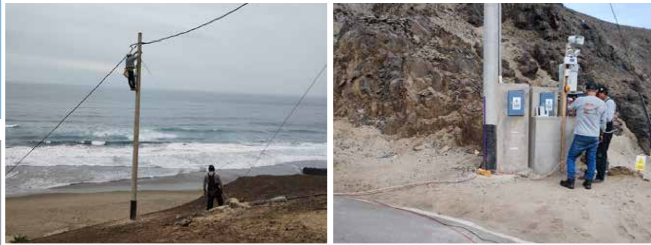
CAMBIO DE CABLES ACERADOS DE BAJA TENSIÓN Y MANTENIMIENTO PREVENTIVO DE TABLEROS ELÉCTRICOS
