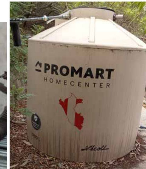
INSTALACIÓN DE TANQUE DE AGUA DE 2,500 LITROS PARA EL ABASTECIMIENTO DE LOS BUNGALOW N° 25 Y N°26
